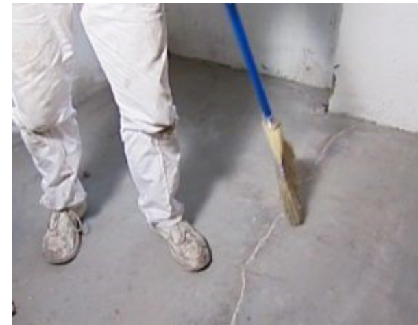
Figura 2 Patrón de agrietamiento típico alrededor de una losa de sótano que debía formarse como una "losa flotante"
