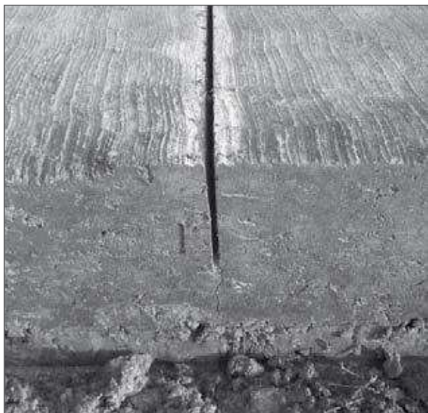
Foto 4. Fisura de retracción formada bajo una junta transversal de retracción serrada tras el hormigonado del pavimento.
