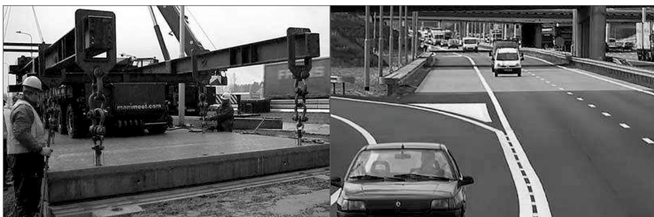
Foto 5. Tecnología ModieSlab en el tramo de pruebas en la A50 y la A12 en los Países Bajos.
