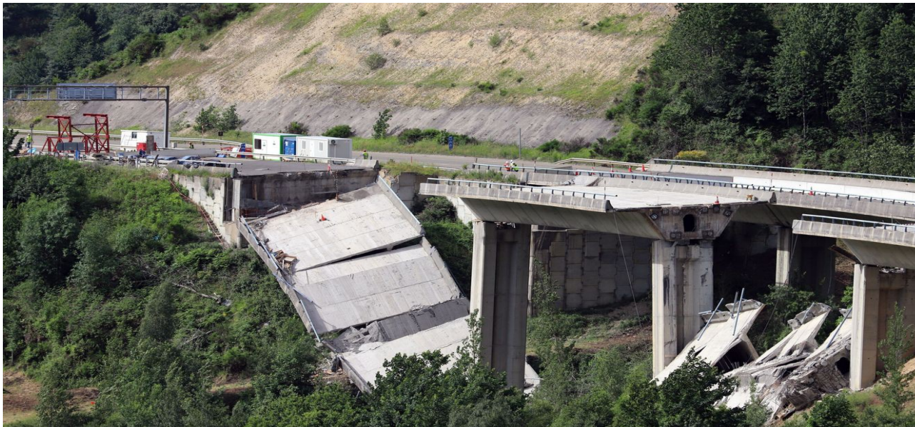
Uno de los dos tramos del viaducto desplomado en el A-6. (EFE)
