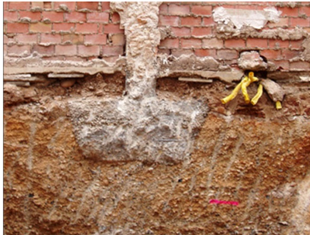
Figura 2. Descalce de una cimentación vecina durante la excavación. Imagen: E. Valiente
