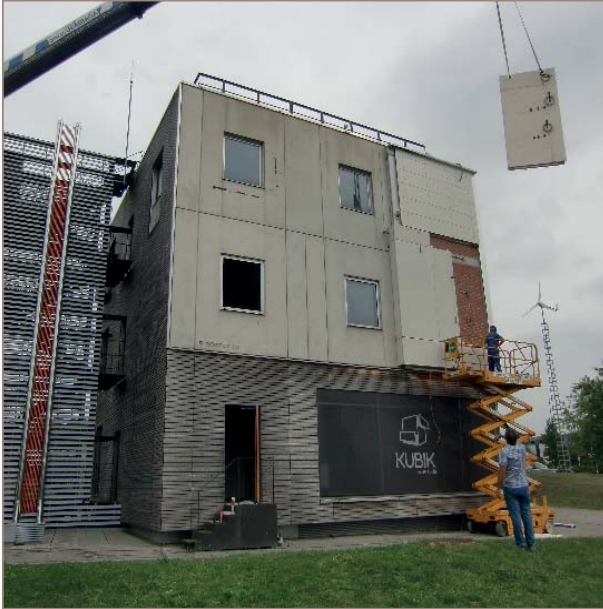
■ Figura 5. Colocación de paneles del proyecto 'ETIXc' financiado por el CDTI (Convocatoria EEA Grants) para el desarrollo de un sistema de aislamiento térmico prefabricado para envolventes de edificación con acción descontaminante y autolimpiante. Edificio Kubik de TECNALIA. (Foto: cortesía de PREHORQUISA).
