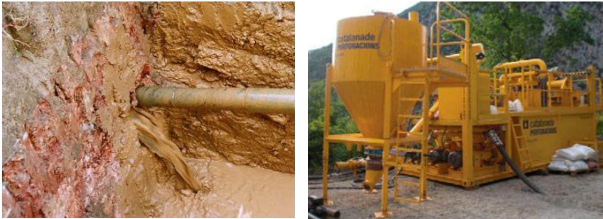
Figura 5. Fluido de perforación y central de tratamiento de lodos. Imágenes de Catalana de Perforacions
