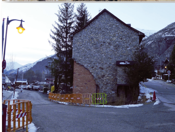
Figura 72. Edificio afectado por la riada de junio de 2013 en el Valle de Arán (Lleida), antes y después de su reconstrucción. Fuente: CCS.
