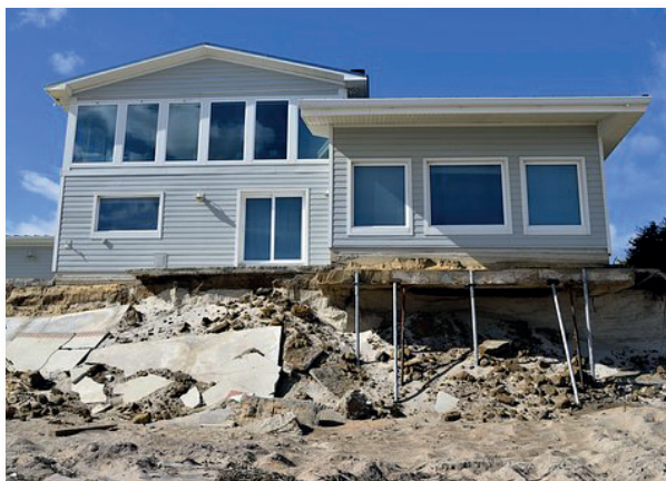
Figura 33. Descalce de la cimentación del edificio por erosión debida al embate de mar.
