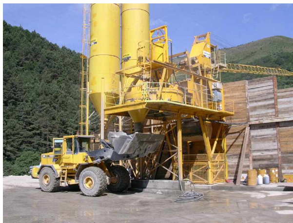
Planta de Hormigón con mezcladora
