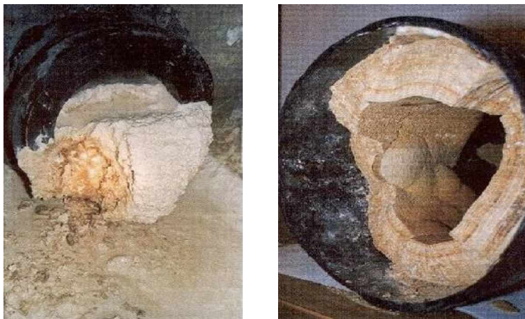
Detalle de drenajes de túnel obturados
