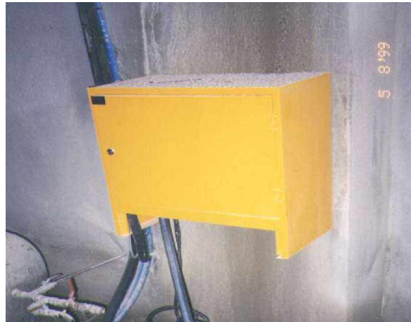
Equipo dosificador de aditivos en planta
