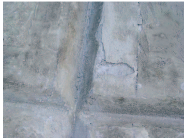
Foto No.5: Delaminación del concreto debida al afinado muy temprano de la superficie.
