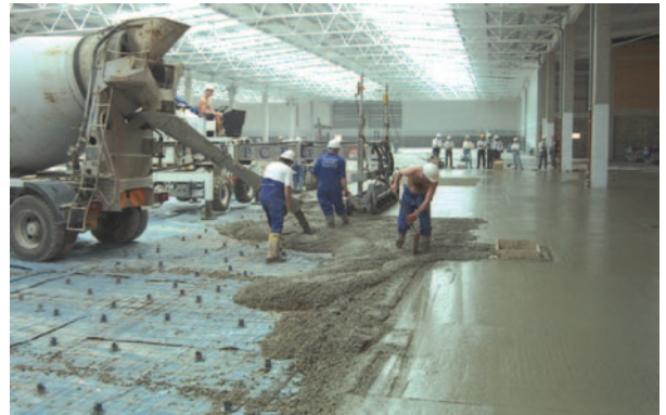
Foto No.4: Aspecto brillante de una losa de concreto debido a la aparición del agua de exudación en su superficie.
