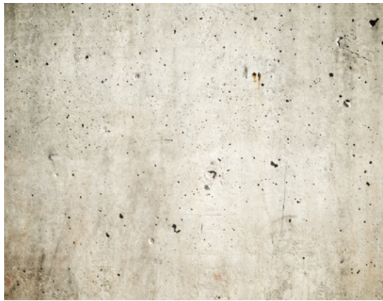
Hormigón con nido de abeja
