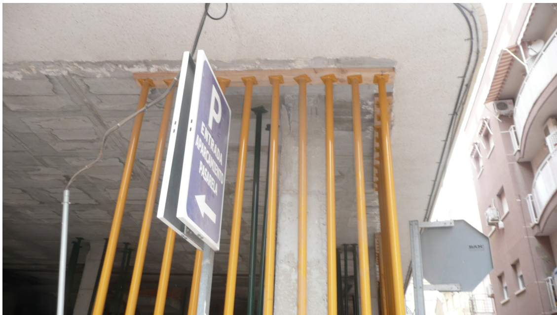
FIGURA 5. Diseño de apeo de pilar y su protección. Lesión en cabeza de pilar con desprendimiento de hormigón. Se ha procedido a su apuntalamiento o apeo porque esta lesión puede conducir a un tipo de colapso frágil del edificio. Además, el apeo realizado es apto para realizar trabajos de refuerzo en cabeza de pilar. Situado en C/ Turbintos, de Lorca.
