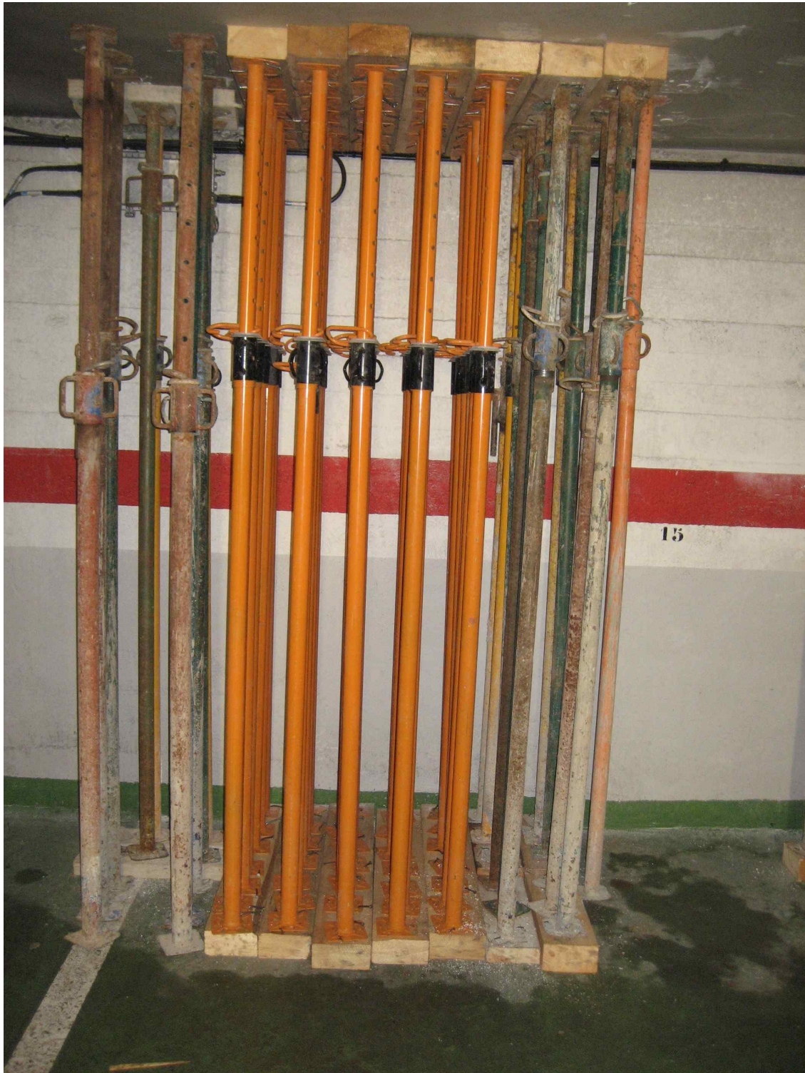
FIGURA 13. Apeo supletorio: Tornapuntas metálicos verticales con durmientes y sopandas de madera, que transmisión de la carga del forjado o de elemento horizontal al suelo o terreno acortando la luz.
