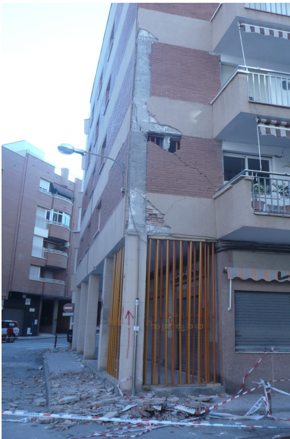
FOTO. Efecto Torsión motivado por el efecto rigidizante de los muros medianeros de un edificio de esquina con grandes deformaciones permanentes en los pilares de la esquina mas alejado del centro de rotación y con cambio brusco de rigidez de la planta baja diáfana parcialmente y las plantas superior cerradas.
