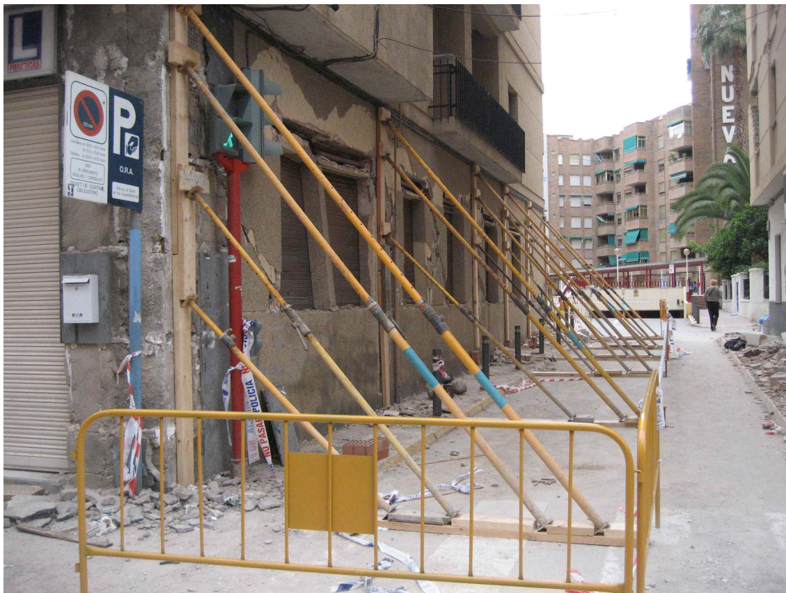
FIGURA 11. Apeo de urgencia o complementario: Tornapuntas metálicos con durmientes y sopandas de madera, tramos de durmientes y sopandas superpuestos que hacen la función de cuñas y aguja o anclaje metálico encajado en el terreno soportando muro de fachada desplomado. Ataja un peligro inminente. No supone una solución de apeo definitiva. Vallado provisional para acotar la zona de seguridad.
