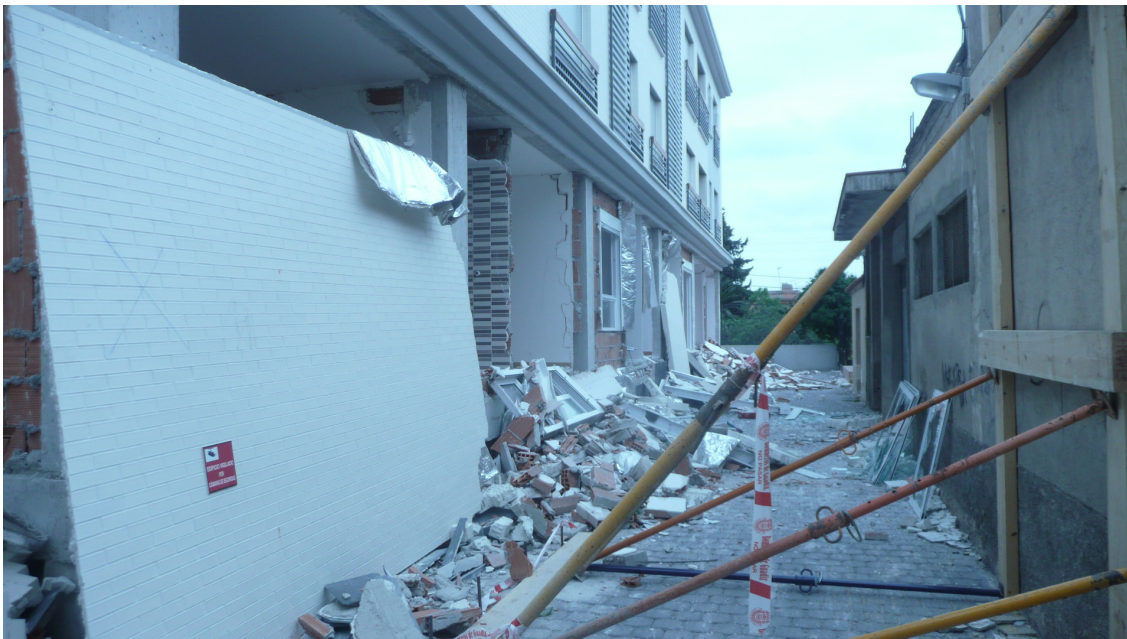
Figura ilustra: Daños no estructurales, en plantas bajas blandas. Las calles estrechas con edificios altos presentan gran vulnerabilidad. Apeo de urgencia o complementario soportando un muro de fachada por peligro de desplome.
