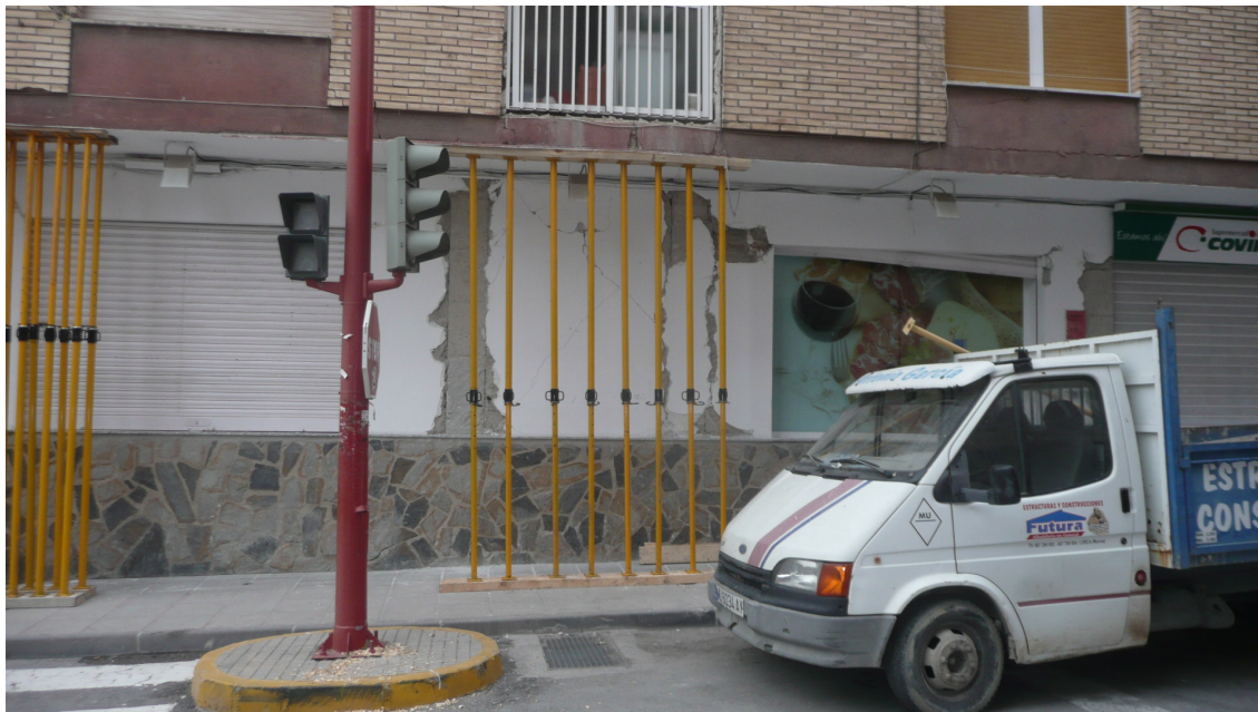
FIGURA 10. Edificio en voladizo. Apeo de urgencia: Complementa la estructura dañada en sus elementos más precarios a corto plazo. Ataja un peligro inminente. No supone una solución de apeo definitiva.
