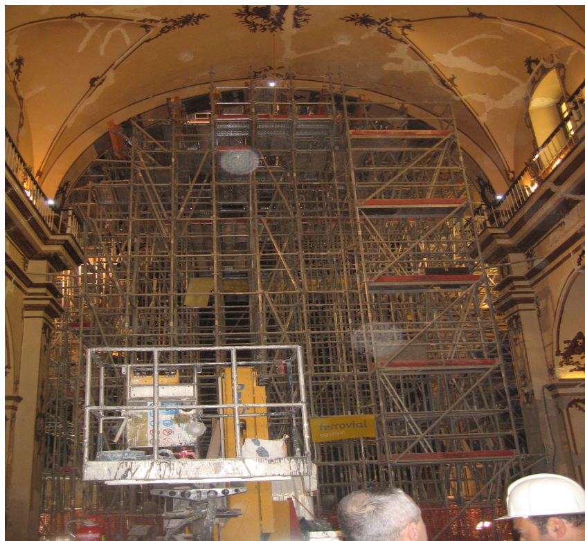
Foto. Daños en cúpula de la Capilla de Nuestra Señora del Rosario.
