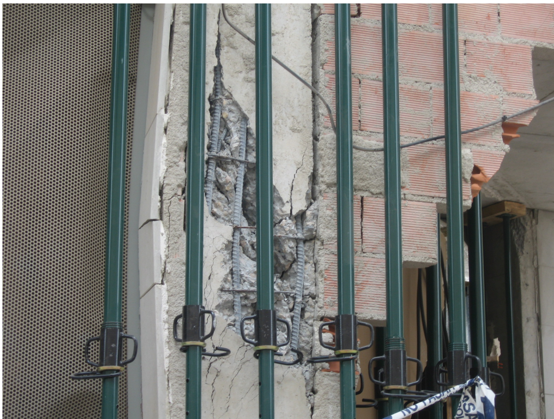
Figura 2. Apuntalamiento urgente de pilar de hormigón armado, con daños graves, ordenado por decisión facultativa. Apeo no apto para la recuperación o sustitución del pilar.
