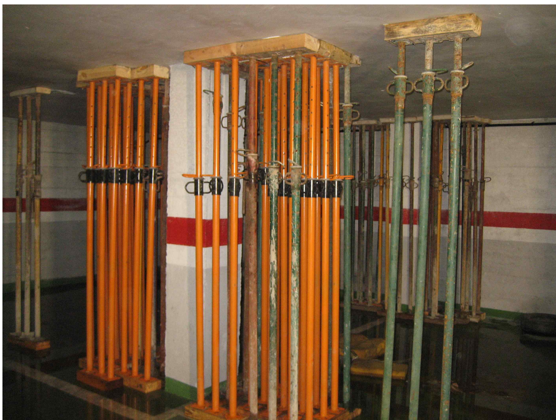
FIGURA 12. Apeo supletorio: Tornapuntas metálicas verticales con durmientes y sopandas de madera, que transmisión de la carga del forjado o elementos horizontal al suelo o terreno acortando la luz. Ataja un peligro inminente. No supone una solución de apeo definitiva. Vallado provisional para acotar la zona de seguridad.
