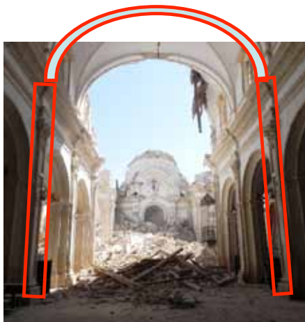
Figura 9.32. Fotografía de la Iglesia de Santiago, tras el derrumbe de la misma, en la que se ha superpuesto la dimensión de pilastras y arcos, con el fin de evaluar (aunque no sea más que de forma geométrica y, por supuesto, intuitiva), la esbeltez de su fábrica.
