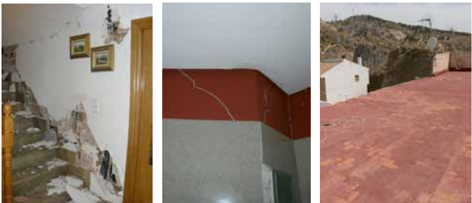
Figura 7.6. Ejemplos de daños en elementos comunes no estructurales interiores y de cubierta.
