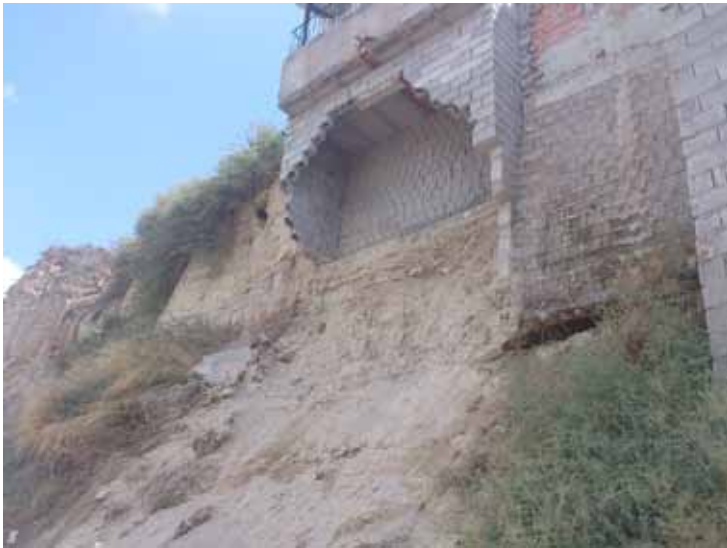
Figura 1.32. Pérdida de cimientos por rotura circular en talud.
