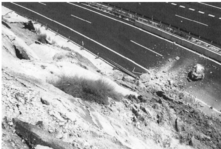
Figura 1.34. Desprendimiento de bloques sobre autovía.
