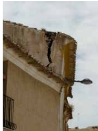
Figura 4.44: Empuje de estructura de cubierta, creando vuelco y grieta lateral más abierta en la zona superior.
