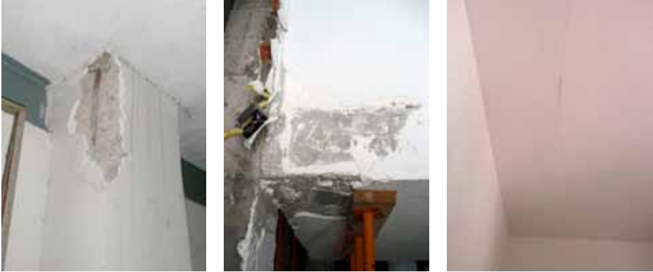
Figura 7.5. Ejemplos de daños en elementos estructurales interiores: 1. Daños en cabeza del pilar con desprendimiento del recubrimiento y deformación de sus armaduras. 2. Daño por cortante en viga. 3. Daños en viguetas por exceso de deformación del forjado.
