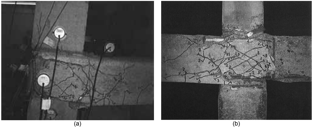
Figura 3.37. Fallo de conexión. (a) Viga plana-pilar exterior. (b) Viga plana-pilar interior. (Fuente: Benavent-Climent, 2010)
