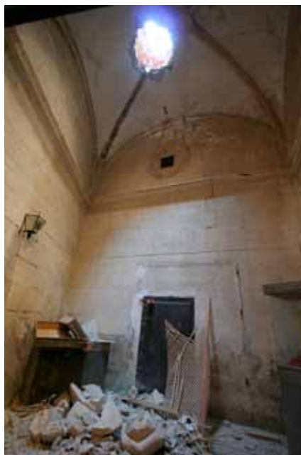
Figura 4.154. Rotura cubierta y bóvedas capilla.
