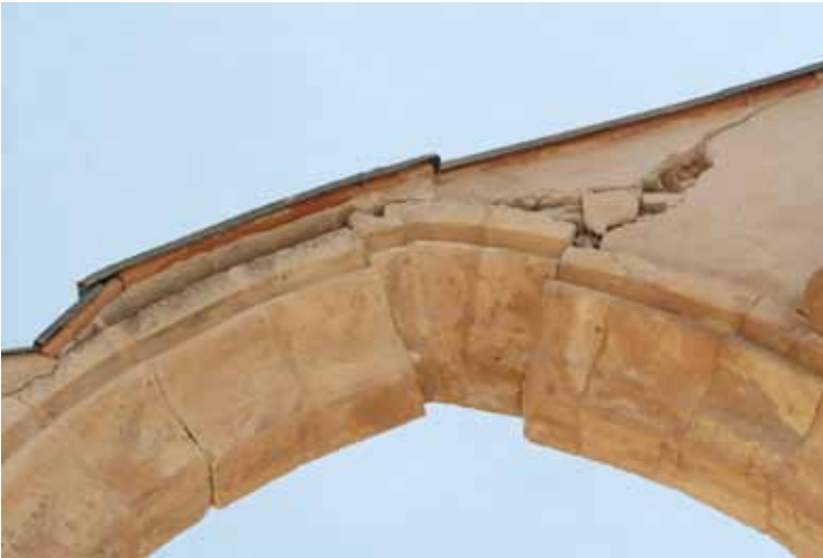
Figura 4.150. Iglesia de Santa María. Desplazamiento de la dovela de la clave del arco de la nave lateral.
