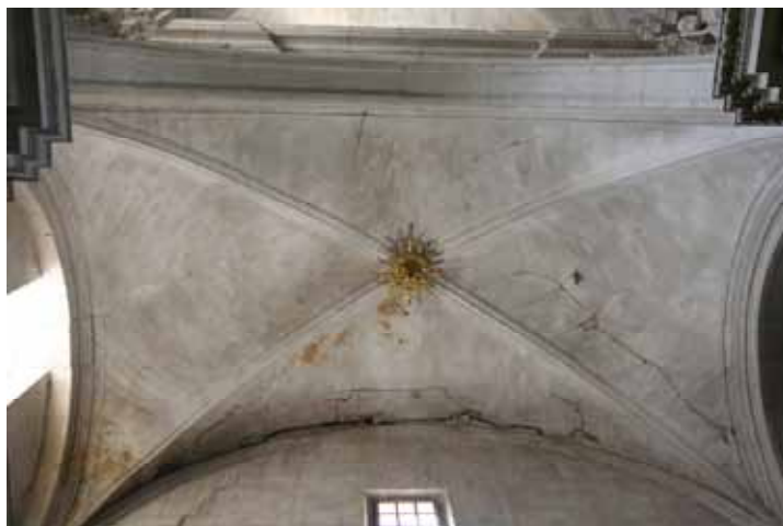
Figura 4.163. Colegiata de San Patricio. Bóveda nave lateral.
