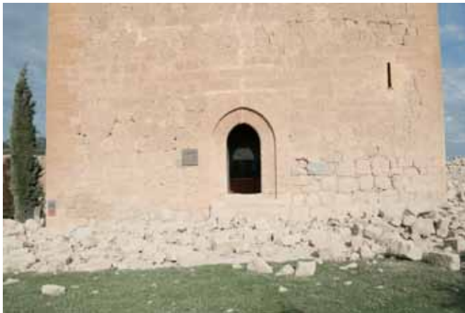
Figura 9.65. Torre del Espolón. Desplome de mampuestos en base de la torre.
