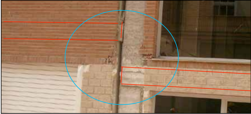
Figura A.1.2. Pilar dañado por golpeteo de forjados a distinto nivel
