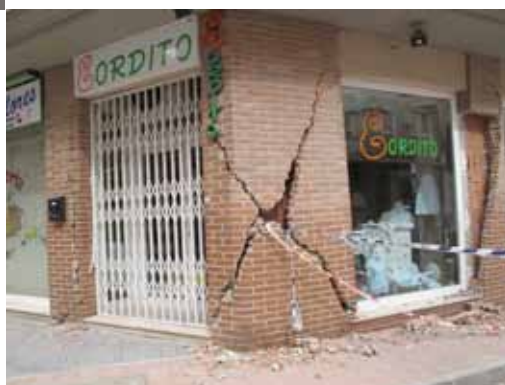
Figura 5.3. Daños en fachadas de planta baja.
