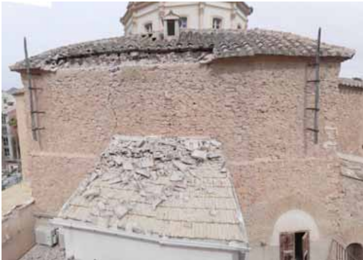
Figura 4.102 47 : Imagen desprendimiento de alero en Lorca.
