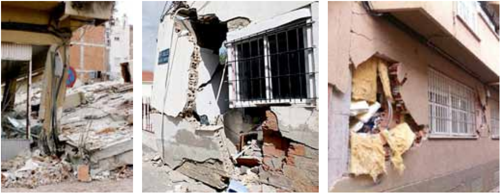
Figura 7.3. Daños por colapso de edificación vecina. 2. Daños en elementos estructurales y no estructurales de fachada. 3. Daños en elementos no estructurales en fachada.
