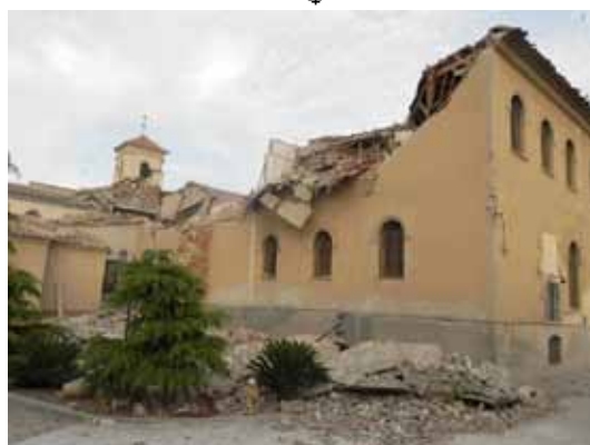
Figura 4.50 34 : Esquema de daños en PARAMENTOS LATERALES por empuje de los pares de cubierta o bóvedas. Caso G : Charnela de vuelco en línea débil en muros con buena traba. Imagen de daño en el Convento de Clarisas en Lorca.
