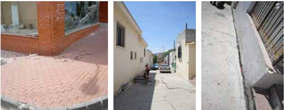
Figura 7.4. Ejemplos de fallos por hundimiento de la cimentación y/o anomalías del terreno.
