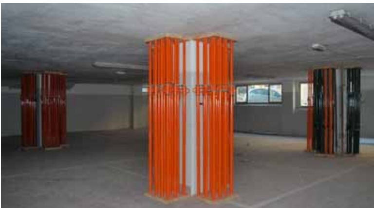
Figura 8.68. Ejemplo con puntales reales colocados en forjado reticular en una planta sótano.
