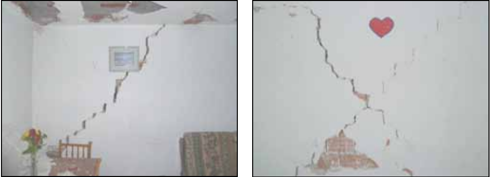
Figura 5.4. Daños en tabiquerías de viviendas.
