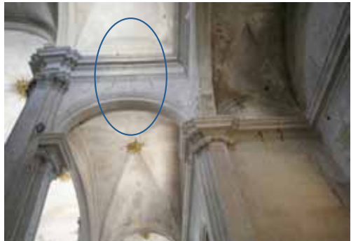
Figura 4.54: Imagen arcos con grietas inclinadas en La Colegiata, Lorca.
