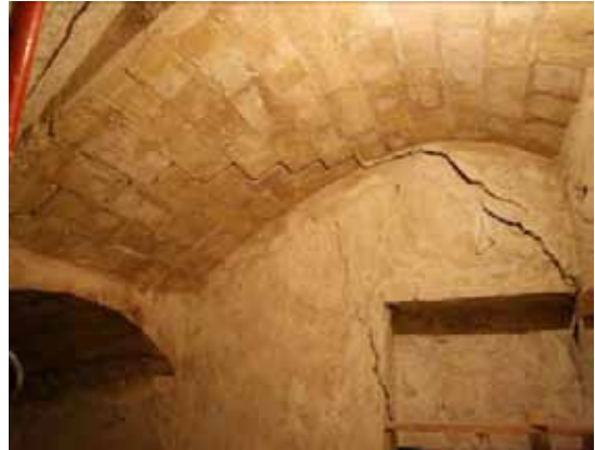
Figura 4.72 37 : Imagen escalera fracturada Lorca.
