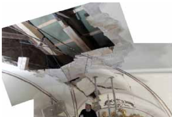
Figura 9.35. Diversas fotografías de la bóveda sobre el coro de la Iglesia de Nuestra Señora del Carmen en los distintos momentos de su reparación.
