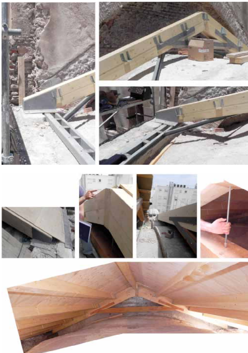
Figura 9.55. Diversas fotografías de la estructura de madera en la cubierta de la Iglesia de Nuestra Señora del Carmen.
