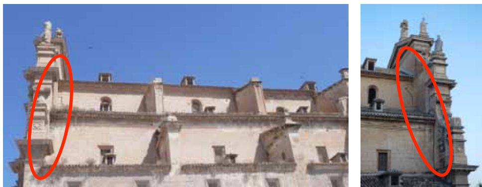
Figura 9.1. Grietas en la Ex Colegiata de San Patricio, en la unión de los muros laterales de las naves, con el imfronte de la fachada principal. El análisis de las mismas, así como la documentación existente, demuestra que no fueron causadas por el terremoto de Mayo de 2.011, sino por uno/s anterior/es
