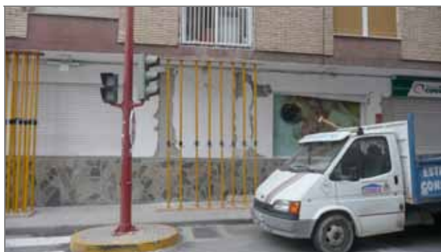
Figura 8.16. Edificio en voladizo. Apeo de urgencia.
