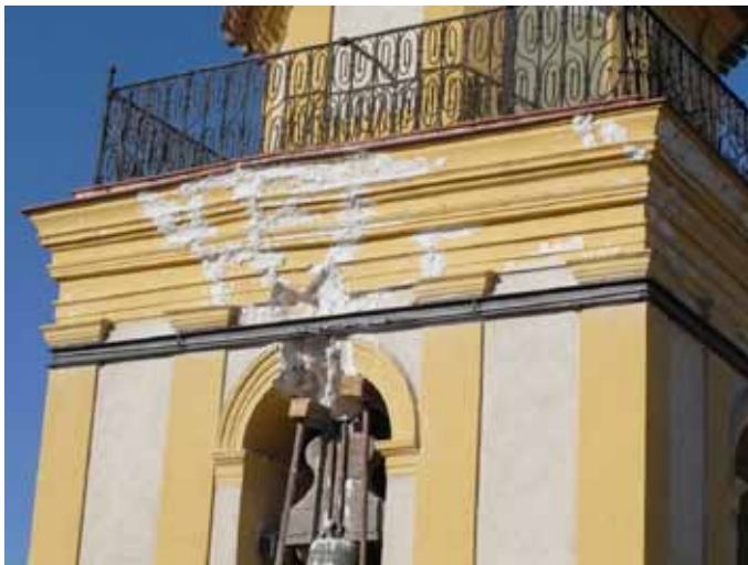
Figura 9.9. Detalle del perfil metálico coyuntural colocado en la torre de la Iglesia de San Cristóbal, alojando en su interior un cable de acero y un tensor, de forma que pueda calibrarse la abertura y tensión del mismo y evitar, por supuesto, que continúe la separación de las fábricas.
