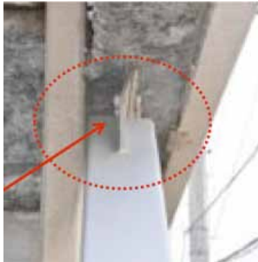
Figura 2.13. Deformación en cartela de unión diagonal-pórtico (Fuente: Ávila, 2011)
