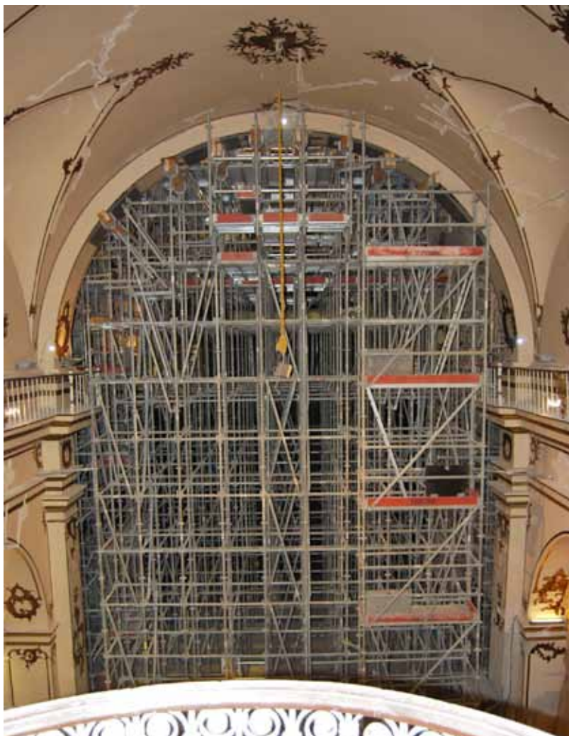
Figura 8.46. Daños en cúpula de la Capilla de Nuestra Señora del Rosario. Lorca. Encimbrado con madera, tubos, bridas y estructura modular de rosetas.
