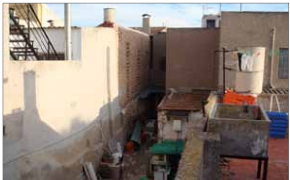
Figura 10.5. Elementos a descontaminar: Depósitos y bajantes de fibrocemento (amianto)
