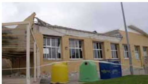
Figura 4.23 27 . Desprendimientos por golpeo entre estructura y revestimientos tras el sismo en Lorca.
