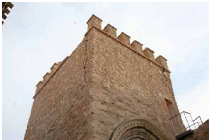
Figura 4.129: Porche de San Antonio. Fractura de las esquinas NO y NE y desplome hacia el interior de almenas.
