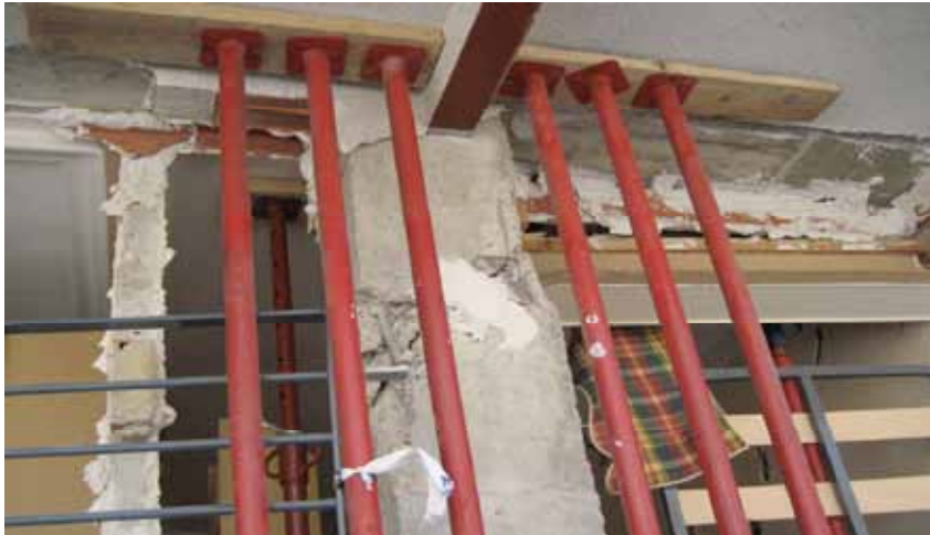
Figura 8.37. Apeo de urgencia pero con carácter supletorio, realizado con puntales telescópicos metálicos para transmisión de carga vertical al suelo o planta inferior.
