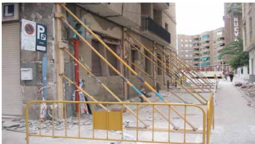
Figura 8.17. Apeo de urgencia o complementario: Tornapuntas metálicos con durmientes y sopandas de madera.
