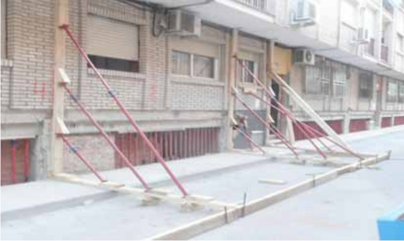
Figura 8.33. Apeo complementario de desplome de cerramiento planta baja coincidiendo con los pilares con la posibilidad de afectación de los mismos.
