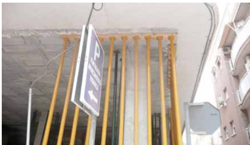
Figura 8.6. Diseño de apeo de pilar. Situado en la Calle Turbintos de Lorca.
