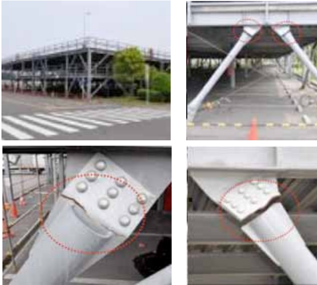
Figura 2.14. Fracturas en las cartelas de unión (Fuente: Ávila, 2011)
