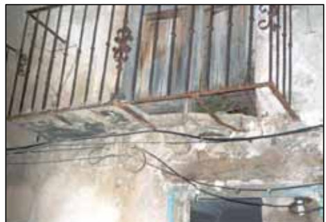
Figura 10.4. Elementos a recuperar.
