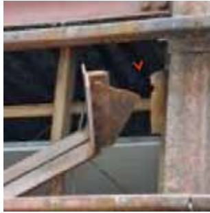
Figura 2.11. Fractura de placa (Fuente: Ávila, 2011)
