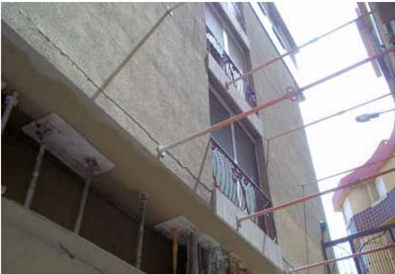
Figura 8.58 Fachada apeada en Lorca. Terremoto Mayo 2011.
