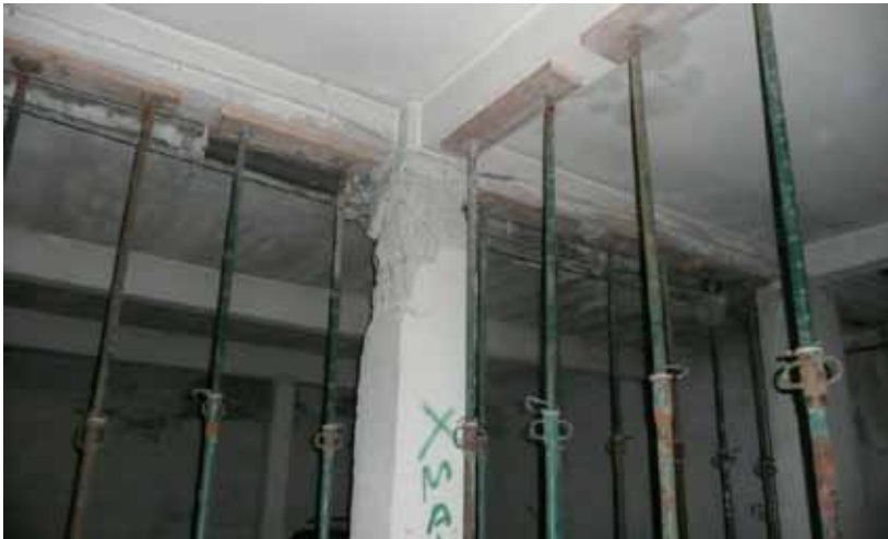
Figura 8.13. Lesión grave en cabeza de pilar de planta sótano por flexión combinado con la carga axial. Residencial San Mateo. Lorca.
