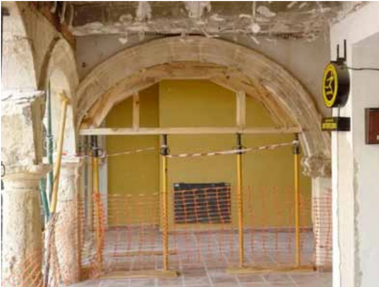
Figura 8.42. Cimbra a base de un armazón de madera no adecuadamente triangulada, careciendo de los elementos indicados en la figura anterior (pares, pendolón, contra-par y puente doble) donde se representan los detalles de cimbra para arcos y bóvedas. (Curso superior de restauración y conservación de la edificación, tema 4 medios auxiliares de Pedro E. Collado.).
