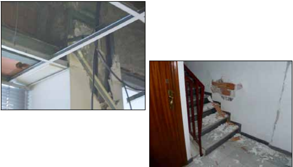
Figura 5.5. Desperfectos en falsos techos y en revestimientos.
