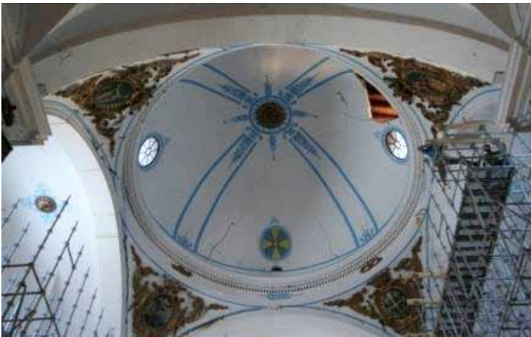
Figura 4.76 41 : Imagen de la iglesia de San Francisco con grietas verticales.
