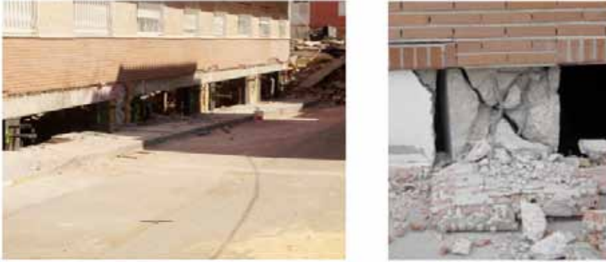
Figura 3.24. Fallo de columna corta (Foto: Dpto. Ing. Civil UPCT, 2011)
