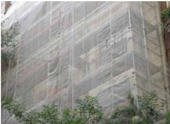
Figura10.35 Redes de protección fachada.
