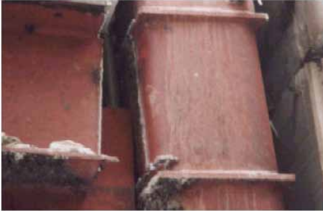
Figura 2.15. Daño unión soldada
