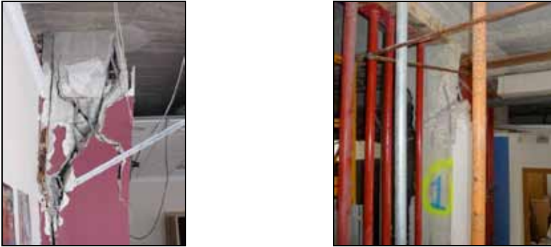
Figura 5.1. Algunos pilares con roturas y desplazamiento.
