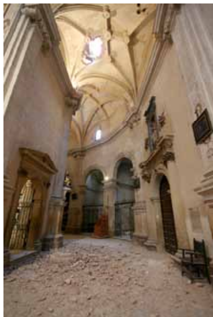
Figura 4.153. Rotura cubiertas y bóveda girola.
