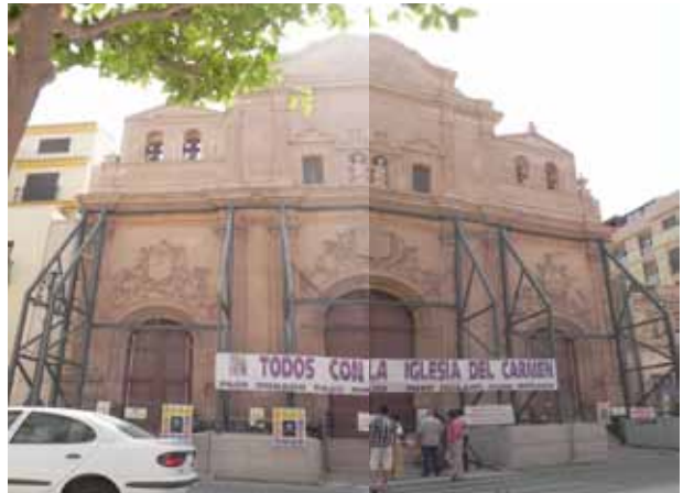
Figura 9.5. Apeo de emergencia colocado en la fachada principal de la Iglesia de Nuestra Señora del Carmen, una vez que se comprobó el movimiento de desplome de la misma hacia la calle.
