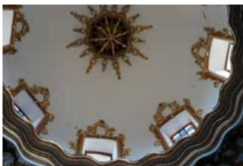
Figura 4.79: Agrietamiento horizontal que recorre el paralelo débil sobre hueco en la cúpula de la Iglesia del Carmen. Lorca.
