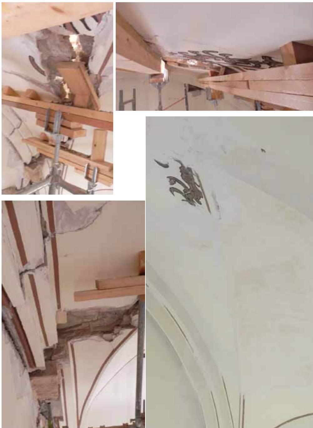
Figura 9.36. Diversas fotografías de la bóveda del crucero del lado del Evangelio de la Iglesia de Nuestra Señora del Carmen en los distintos momentos de su reparación.
