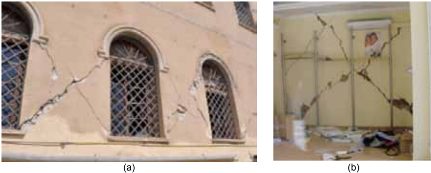
Figura 3.45. Agrietamiento en cruz. (a) En muro (Foto: Bomberos de Cartagena, 2011). (b) En tabiquería (Foto: Dpto. Ing. Civil UPCT, 2011)
