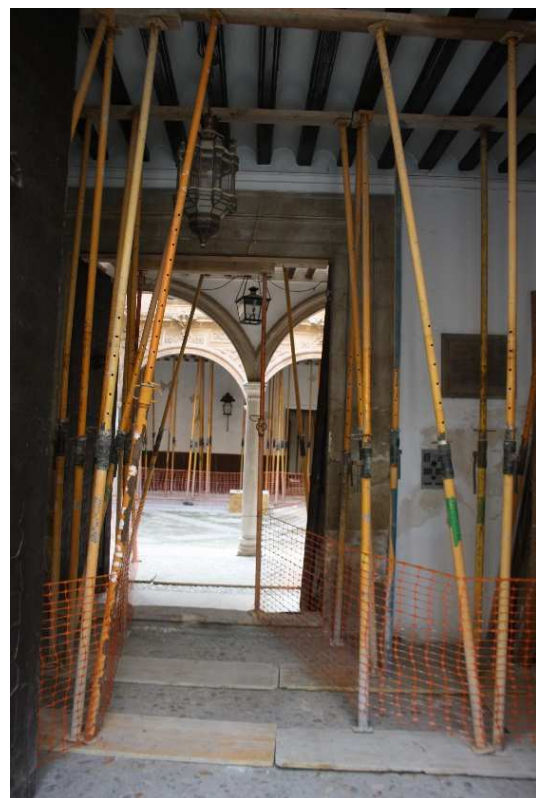
Figura 3.64. Puntales trabajando de forma incorrecta
